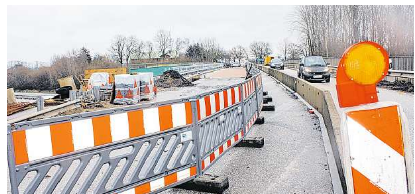
1,3 Millionen Euro sind für die Sanierung der Brücke im Verlauf der B 208 veranschlagt. Sie kann nur einspurig befahren werden. FOTO: M. THORMÄHLEN
